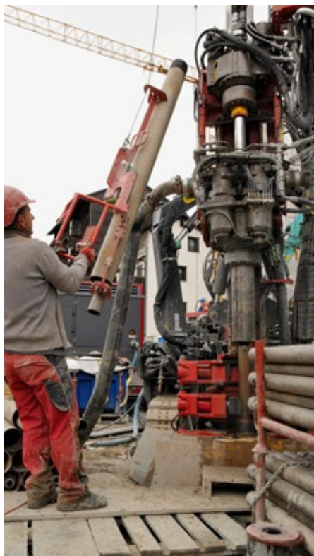
Avesco, Baustelle Zermatt, Erdsonden-Bohrgerät Klemm, Bohrmeister Savo Dragojlovic (links) im Gespräch mit Renato Genasci, Avesco.
