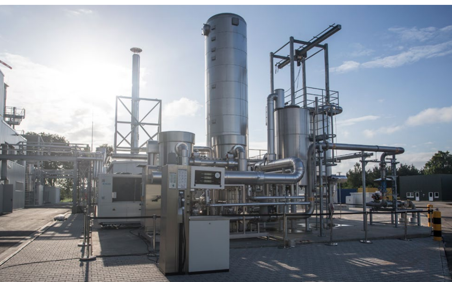
HZIBM-Lavage aux amines de l'usine à E-gaz d'AUDI à Werlte/DE (Photo: Audi AG)
