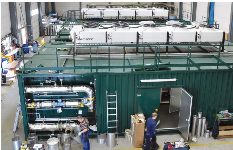
Hall de production sur le site de Zeven/DE
