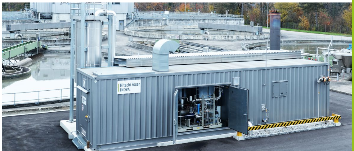
Épuration des effluents gazeux par technologie membranaire à Zuchwil/CH
