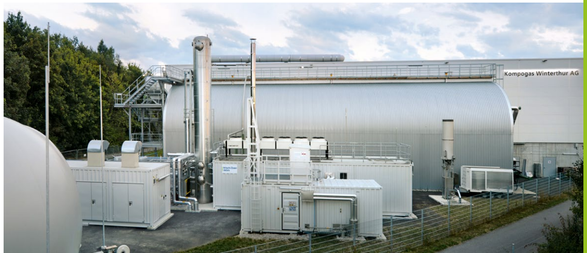
Épuration du biogaz issu de la fermentation par voie sèche Kompogas®- par lavage aux amines à Winterthur/CH
