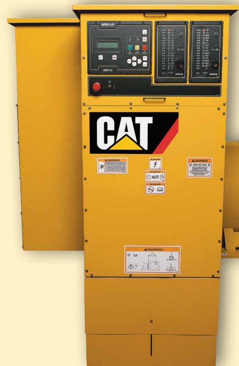
Überwachung und Generatorschalter
