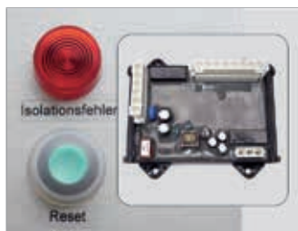
Isolationsüberwachung Die Verbraucher schalten sich automatisch ab, wenn der Isolationswiderstand einen kritischen Wert erreicht hat.
